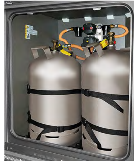
Les bouteilles du réchaud de camping sont en principe bloquées pour éviter tout déplacement.
